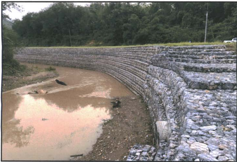
รูปที่ ๑ ลักษณะความเสียหายเนื่องจากน้ำกัดเซาะบริเวณท้ายน้ำของท่อลอดตามขวางและพื้นที่ที่เป็นคั้งน้ำที่มีทิศทางการไหลเข้าสู่คันทาง
