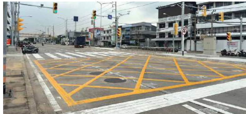
ทล.303 กม.18+730 (หน้า ซ. ส.ไทยเสรี 2) จ.สมุทรปราการ
