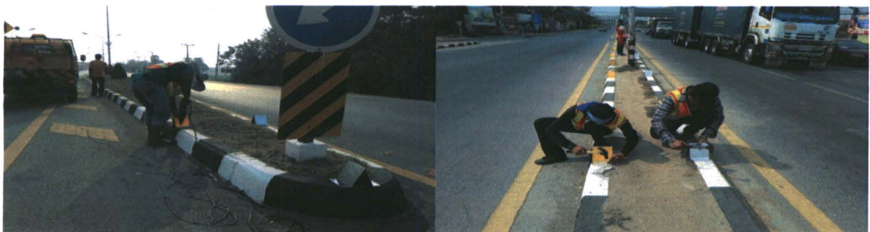
รูปที่ ๒๔ แสดงตำแหน่งการติดตั้งเป้าสะท้อนแสงบนคันหินบริเวณหัวเกาะในปัจจุบัน
