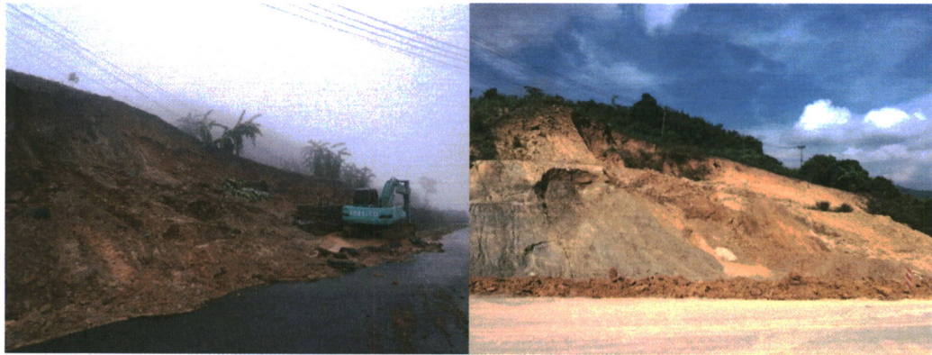
รูปที่ ๑ ดินสไลด์ในพื้นที่ก่อสร้าง
